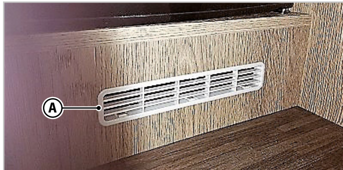
Joon.6.1 - Püsivad ventilatsiooniavad
