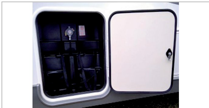
Εικ.6.26 - Χώρος φιαλών αερίου
